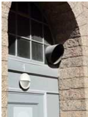
1. Outside Vattenporten 6 aeration system
